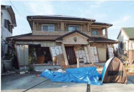
熊本地震後の住宅（1）の外観。1階が西側に大きく傾き、隣家の壁にもたれ掛かっている。 （資料：日経ホームビルダー）
